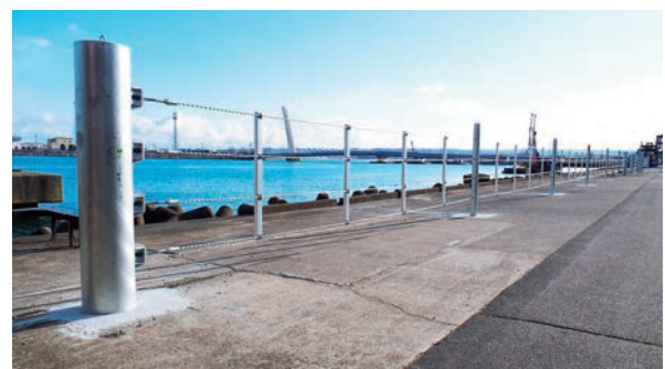
津波・漂流物防護柵（津波ガード）
