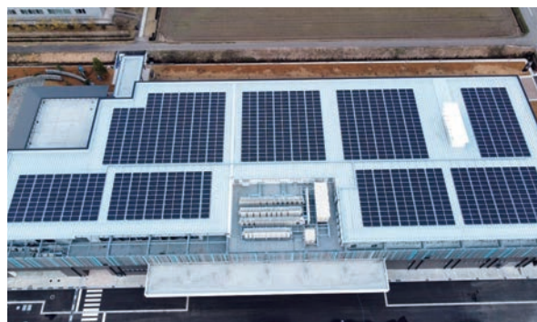
立山科学本部工場屋上設置 太陽光パネル (北陸電力 オンサイトPPAサービス)
